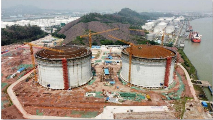
LNG Emergency Peak Gas Source Station LNG应急调峰气源站
