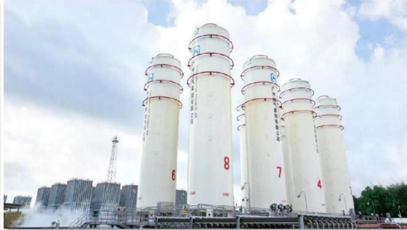
LNG Gasification Station LNG气化站
